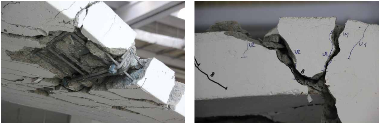
Rys. 78. Szczegóły zniszczeń Modelu 1
