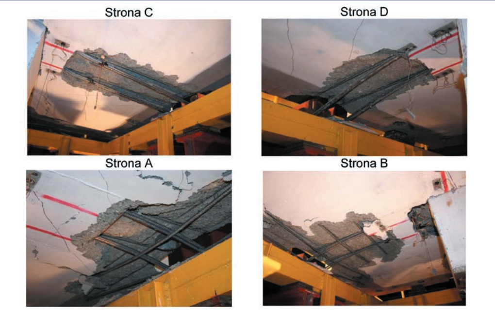
Rys. 12 USZKODZENIA OTULINY DOLNEGO ZBROJENIA MODELU PII/12-1 (STAL ZIMNO- WALCOWANA)
